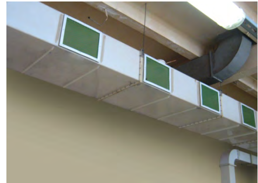
Рис. Воздуховод вентиляционной системы с вентиляционными решетками, соединение фланцевое
