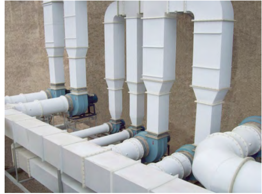
Рис. Вытяжная система из полипропилена в гальваническом цехе
