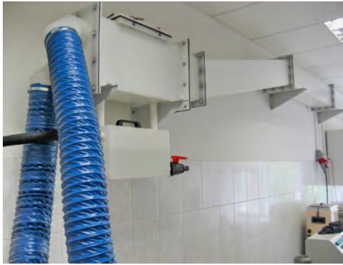
Рис. Вытяжная вентиляционная система из полипропилена в химлаборатории
