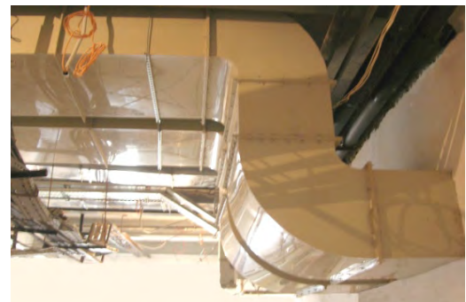
Рис. Воздуховоды из полипропилена приточной вытяжной вентиляции от гальванических ванн
