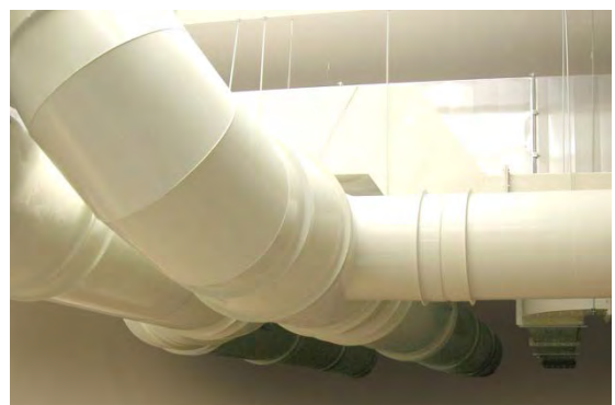
Рис. Воздуховоды из полипропилена приточной вытяжной вентиляции от гальванических ванн
