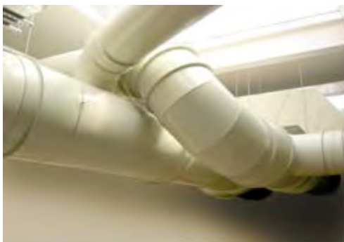
Рис. Воздуховоды из полипропилена приточной вытяжной вентиляции от гальванических ванн
