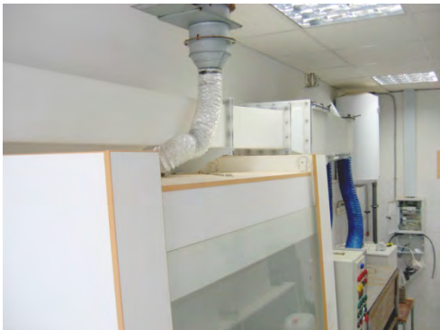
Рис. Вытяжная вентиляционная система из полипропилена в химлаборатории
