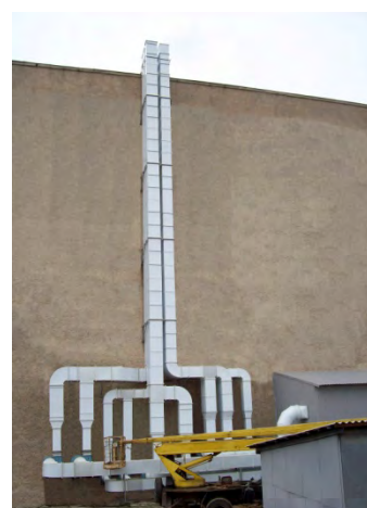
Рис. Вытяжная система из полипропилена гальванического цеха
