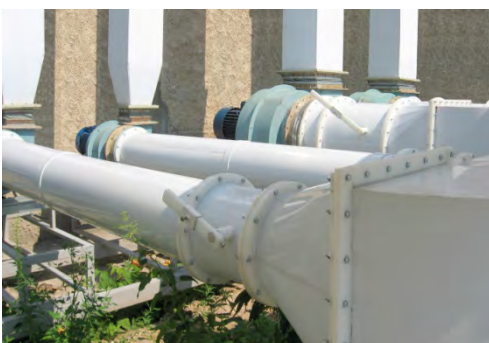
Рис. Вытяжная система из полипропилена в гальваническом цехе
