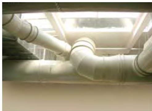
Рис. Воздуховоды из полипропилена приточной вытяжной вентиляции от гальванических ванн
